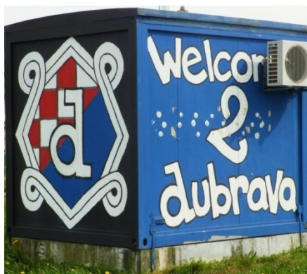
Slika 80. Teritorijalni i navijački grafit na trafostanici na ulazu u Dubravu
