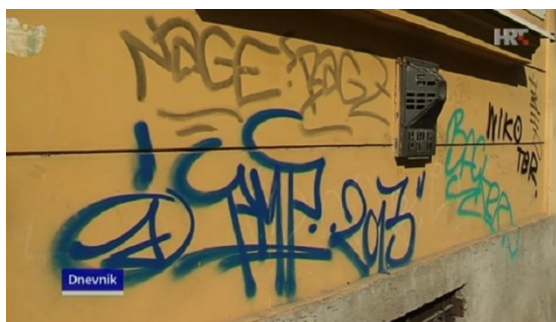
Slika 127. Vandalsko šaranja grafitima po fasadi zgrade
