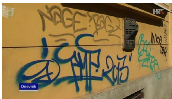
Slika 127. Vandalsko šaranja grafitima po fasadi zgrade
